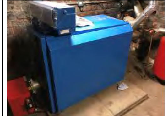
Modern non ACM boiler
