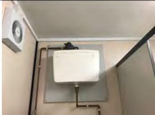
Modern non ACM toilet cistern
